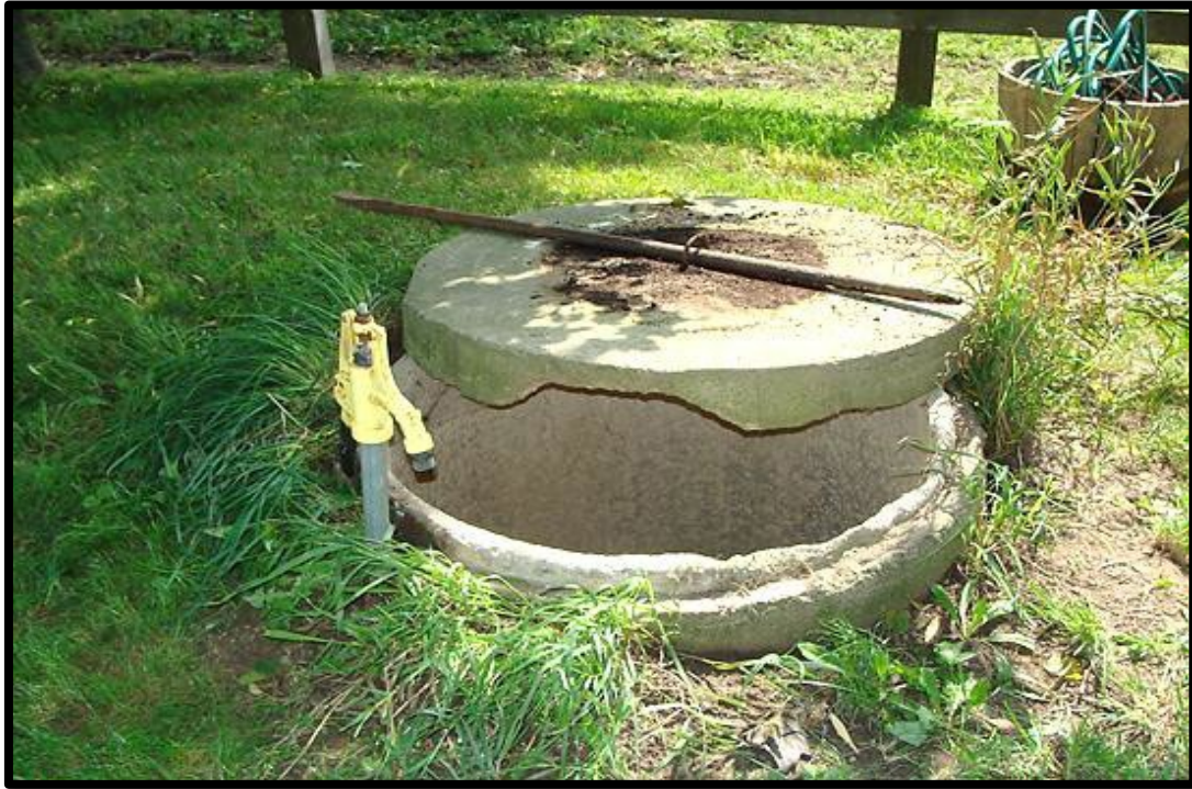
Figure 1 : Tubage et couvercle de puits endommagés
