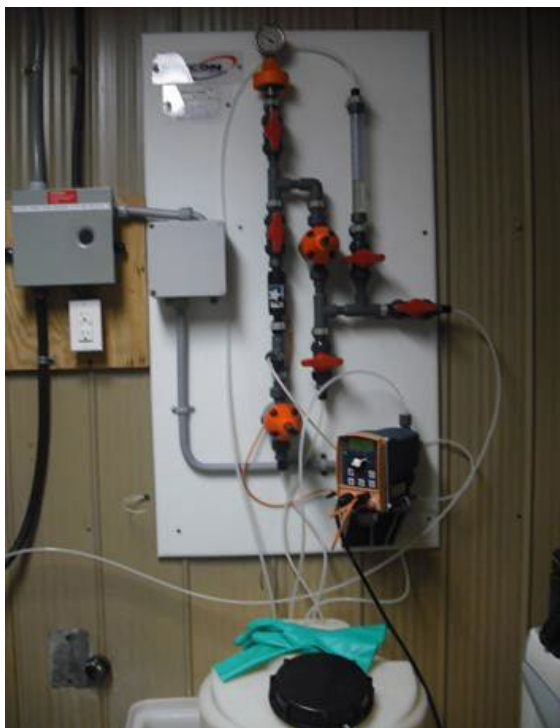
Figure 3 : Injecteur de chlore
