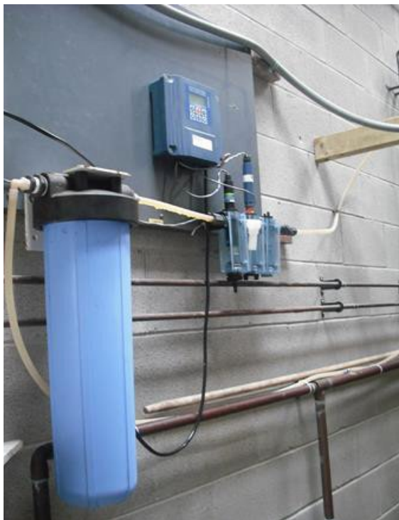
Figure 4 : Système de contrôle du chlore et du pH
